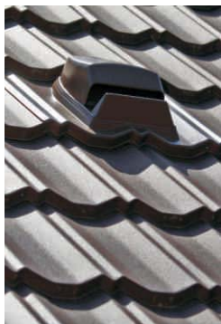
Ventilație de câmp
