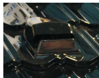
Ventilație de câmp
